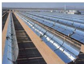
利用集熱器產生蒸氣發電
