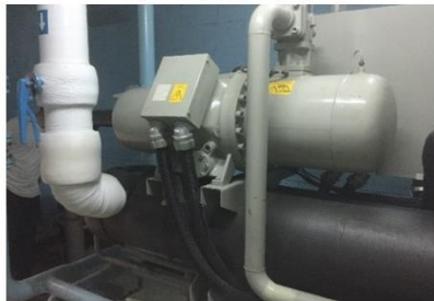
冰水主機現勘
